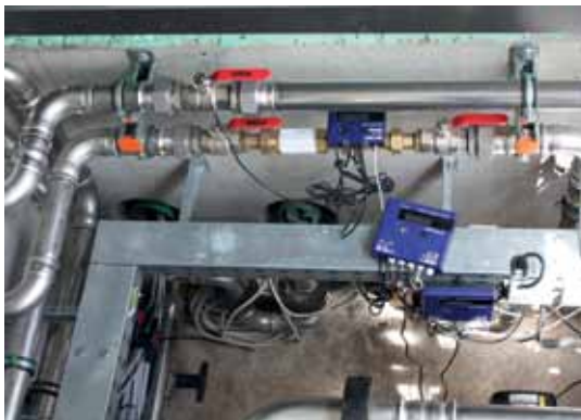
Es gibt nicht „den einen Standard“: Wärmemengenzählertechnik muss sich eng an den messtechnischen Anforderungen, am Installationsumfeld und an den jeweiligen Medien ausrichten. Daher wurden auch im Rahmen des Forschungsprojektes drei verschiedene Molliné-Wärmemengenzähler installiert, hier Ultramess C3U und Ultramess S3 Split.
