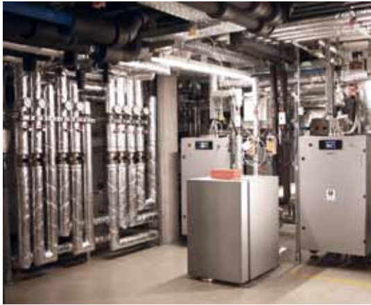
Von der Bereitstellung der Energie, u. a. über zwei BHKW im Keller des Institutsgebäudes, bis zu den einzelnen Verbrauchern werden die Energieströme durch Ultraschallwärmemengenzähler von Molliné lückenlos erfasst und ausgewertet.
