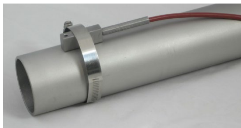
Abbildung 22: Pt100 auf Rohrleitung montiert
